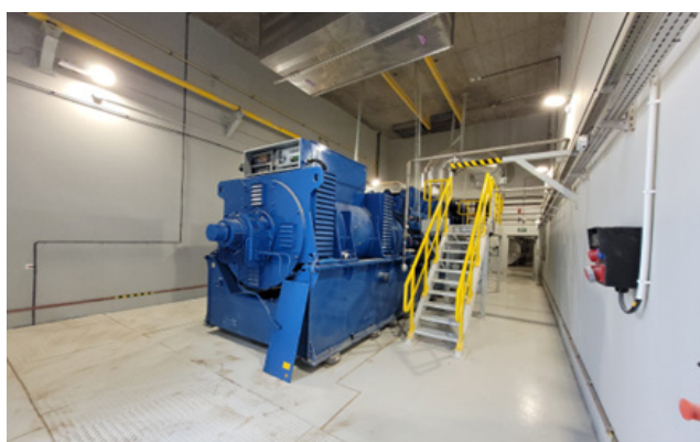
Silnik wraz z generatorem
